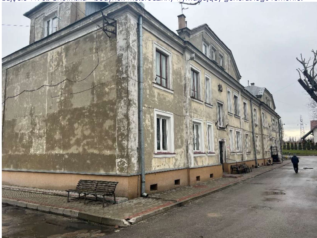
Zdjęcie 11. Ul. Chełmska – budynek wielorodzinny wymagający generalnego remontu.
